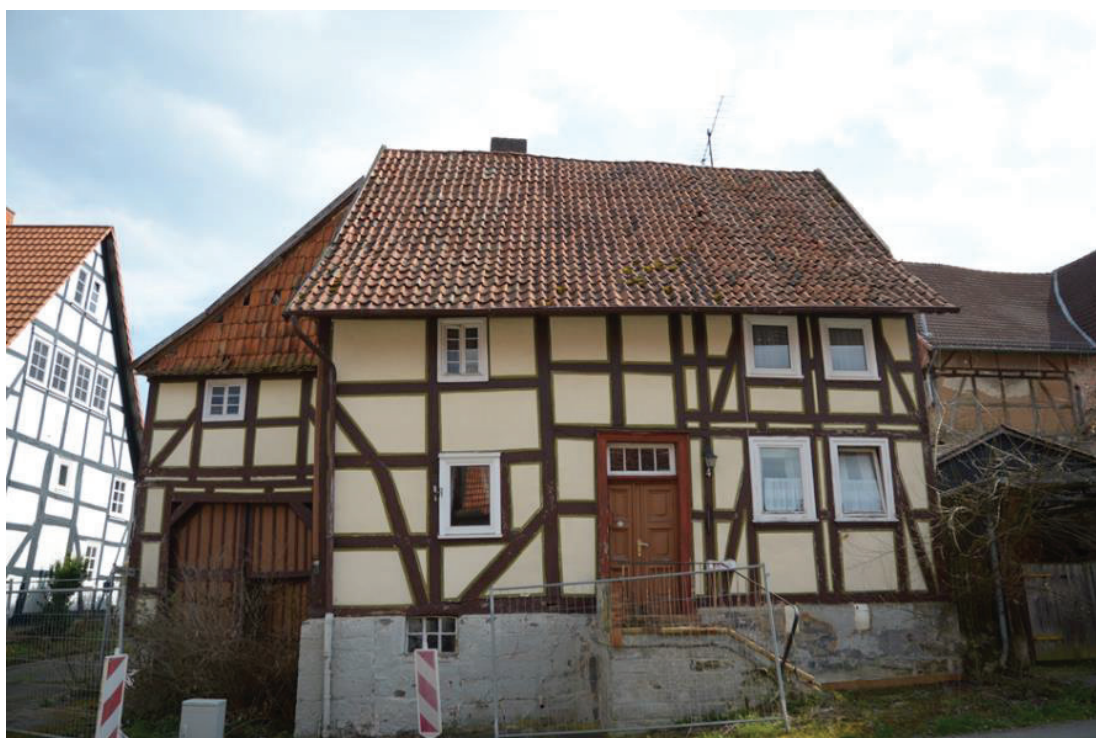
Ortsbildprägende und akut gefährdete Bausubstanz Rauteweg 4 (Foto: ANP)
