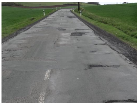
Straßenschäden auf L 3312 zwischen Nothfelden und Niederelsungen
