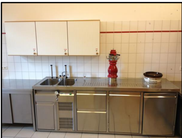
Voll ausgestattete Großküche
