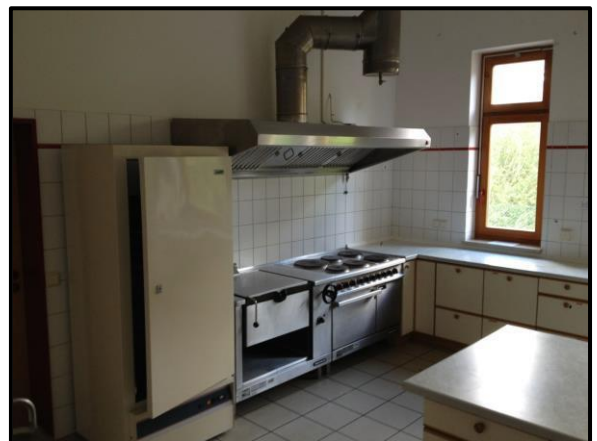
Voll ausgestattete Großküche
